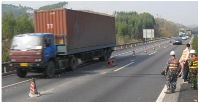
图B.3 G4京港澳高速公路广东韶关段养护大修施工作业区运行状况
