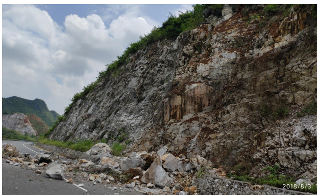
图7 来马路某边坡危岩崩塌
