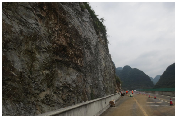
图6 河都路某边坡危岩落石
