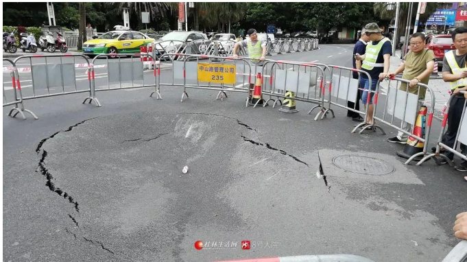
图 1 桂林市某道路路基塌陷
