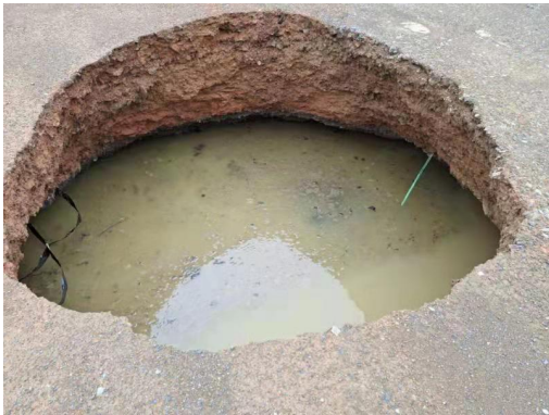
图 2 武鸣府城至隆安公路路基塌陷
